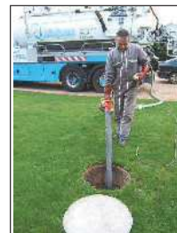
Vidange d'un ANC existant
