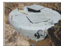
Mise en service d'un ANC existant
