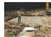
Installation de l'ANC
