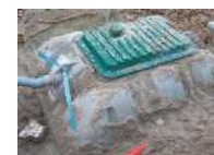
Installation de l'ANC
