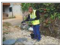
Mise en service d'un ANC existant
