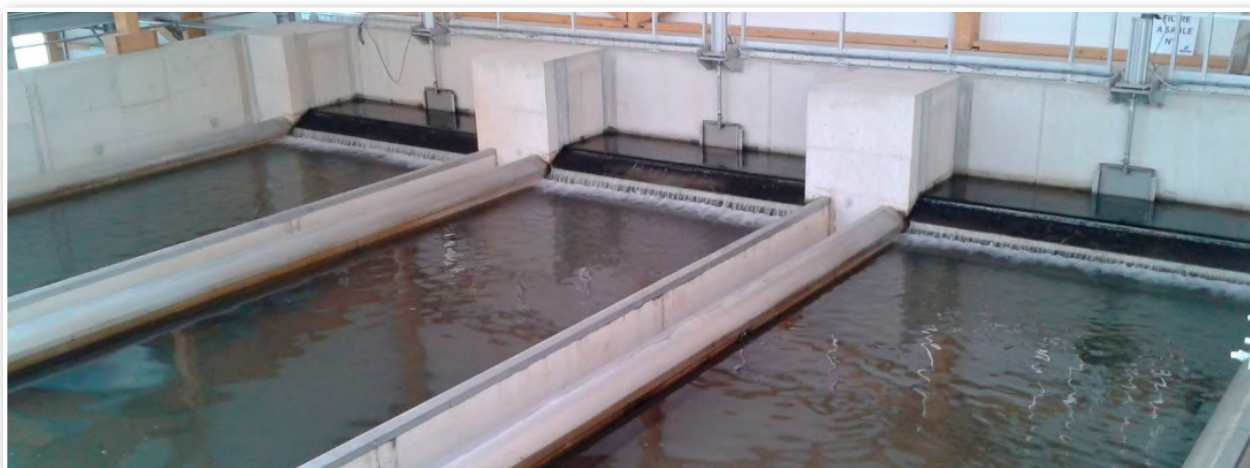
Station de traitement de Saint-Émiland - Filtre à sable (SMEMAC)
