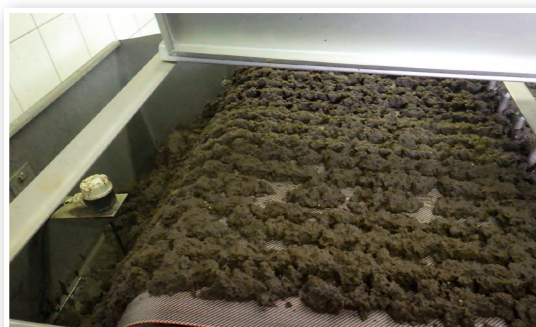
Déshydratation des boues produites avant stockage
